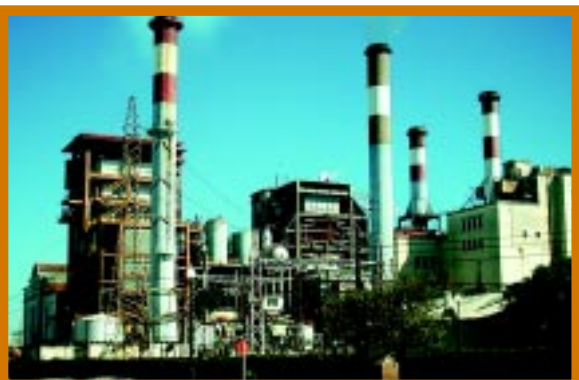
Central Termoeléctrica de respaldo: Central Batlle
